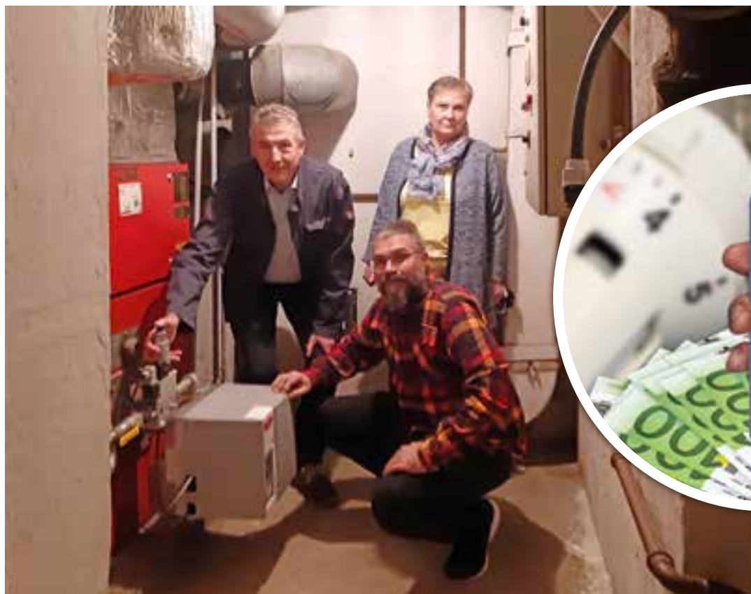
Energiesparen vor Ort: v.l. Wolfgang Wagner (Kirchenvorstand), Margarethe Kopiel (Küsterin) und Oliver Leu (Pfarreirat) an der Heizungsanlage der Herz-Jesu-Kirche in Röllinghausen.
